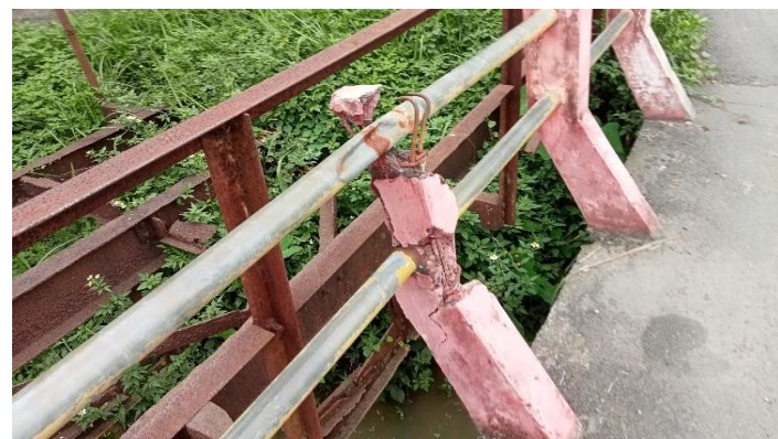
TIANG SANDARAN PECAH
