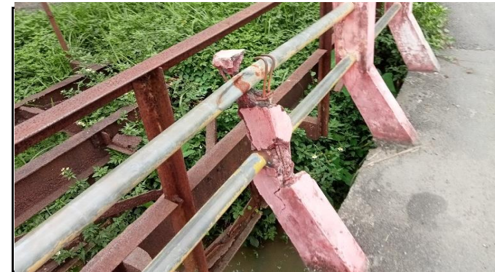
TIANG SANDARAN PECAH
