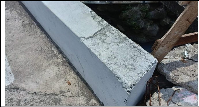
KERETAKAN PADA SANDARAN
