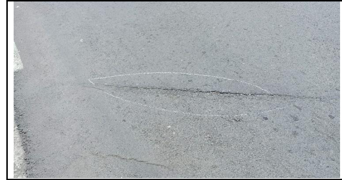
LAPISAN PERMUKAAN LANTAI RETAK
