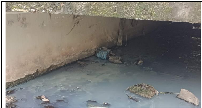
PENURUNAN MUTU BETON PADA KEPALA JEMBATAN DAN PELAT JEMBATAN
