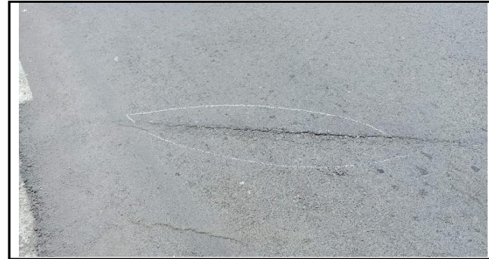
LAPISAN PERMUKAAN LANTAI RETAK
