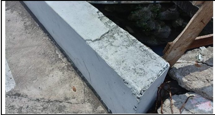
KERETAKAN PADA SANDARAN
