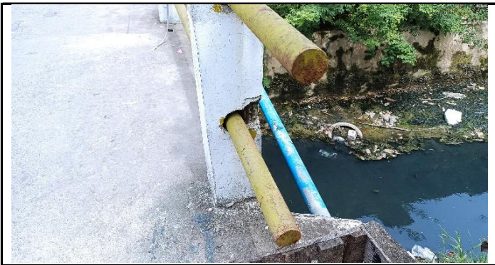
TIANG SANDARAN RETAK
