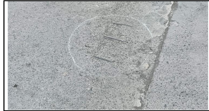
KONDISI LANTAI JEMBATAN (KARAT PADA TULANGAN)
