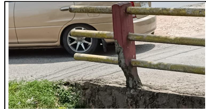
KONDISI TIANG SANDARAN RONTOK BETON
