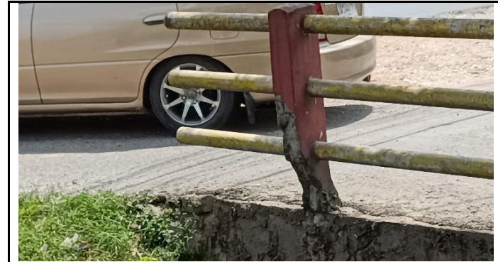
KONDISI TIANG SANDARAN RONTOK BETON
