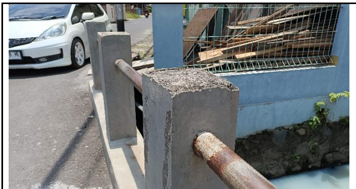
TIANG SANDARAN MENGALAMI KERONTOKAN BETON
