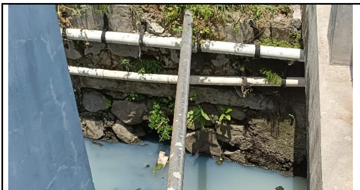
KONDISI KOROSI PADA PIPA UTILITAS
