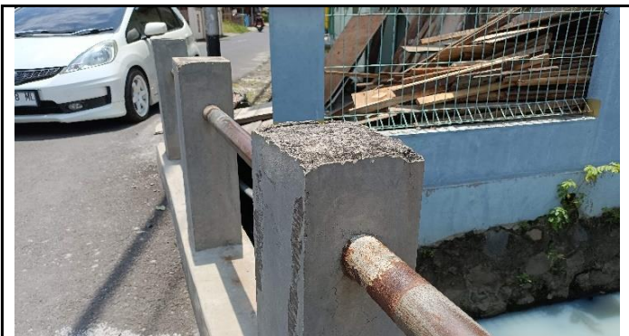
TIANG SANDARAN MENGALAMI KERONTOKAN BETON
