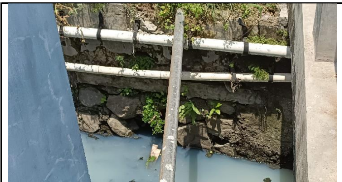
KONDISI KOROSI PADA PIPA UTILITAS
