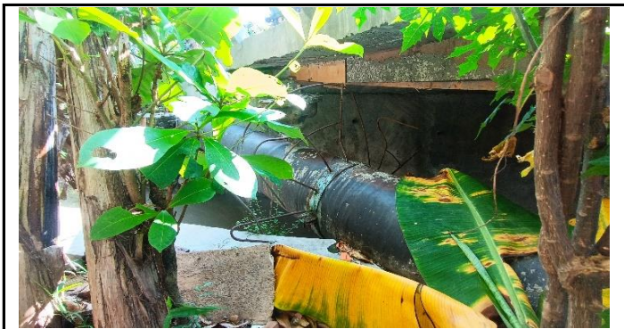
KONDISI UTILITAS PADA JEMBATAN
