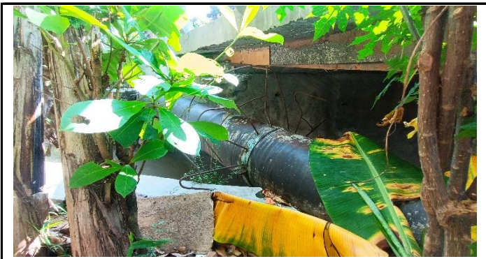
KONDISI UTILITAS PADA JEMBATAN
