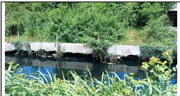
TEBING SUNGAI PECAH DAN RONTOK PADA BETON
