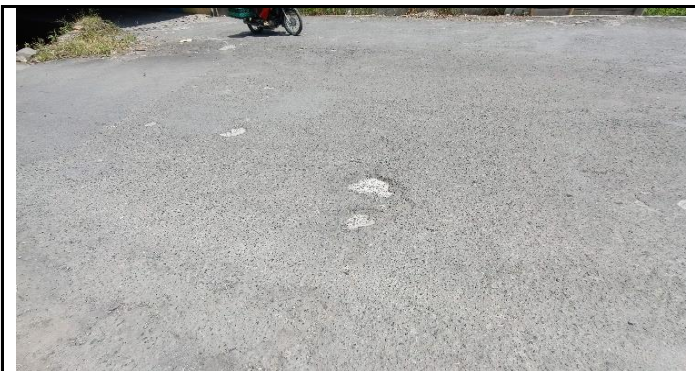
LAPISAN PERMUKAAN LANTAI JEMBATAN BERLUBANG
