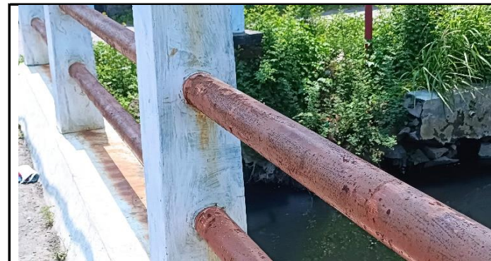
SANDARAN HORIZONTAL KOROSI
