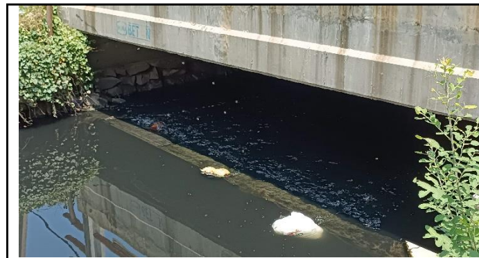
KONDISI BANGUNAN BAWAH DAN SEDIMENTASI SUNGAI
