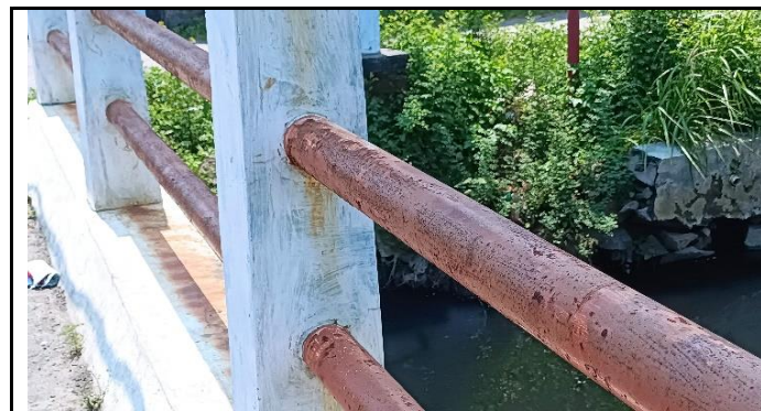
SANDARAN HORIZONTAL KOROSI
