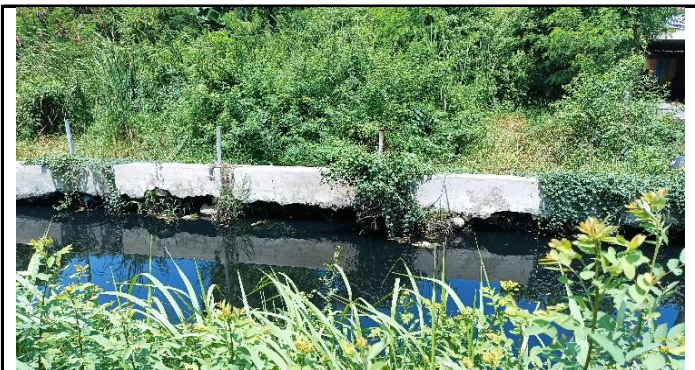
TEBING SUNGAI PECAH DAN RONTOK PADA BETON
