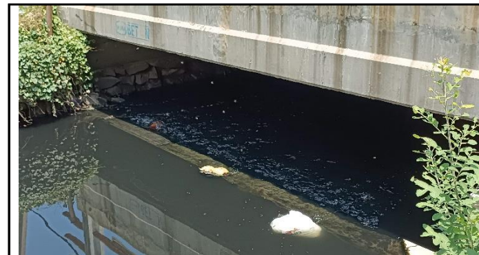
KONDISI BANGUNAN BAWAH DAN SEDIMENTASI SUNGAI
