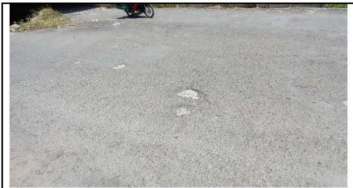
LAPISAN PERMUKAAN LANTAI JEMBATAN BERLUBANG
