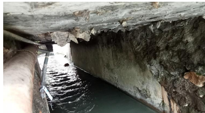
KEPALA JEMBATAN PECAH
