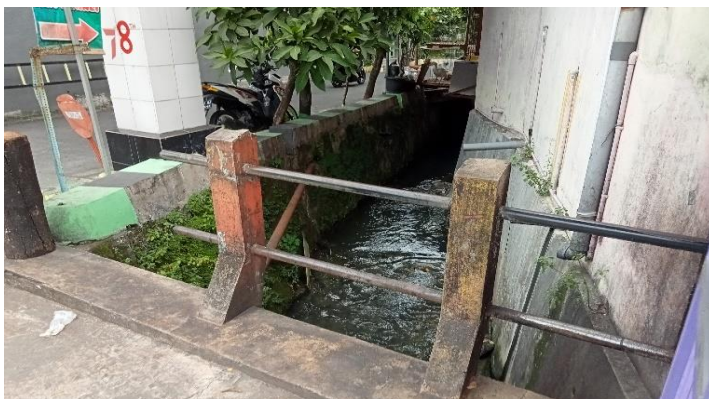
CAT PADA SANDARAN SUDAH KUSAM
