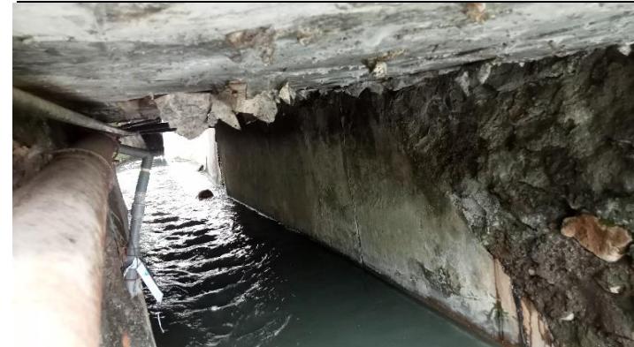
KEPALA JEMBATAN PECAH
