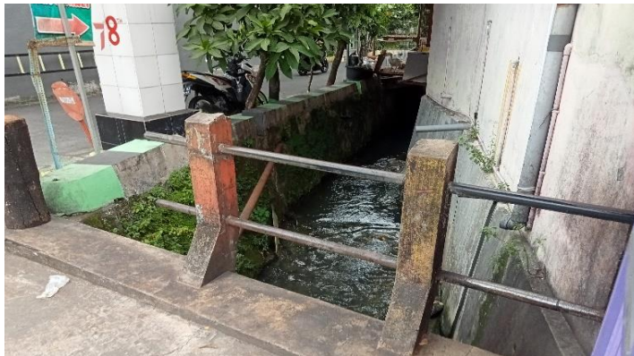
CAT PADA SANDARAN SUDAH KUSAM
