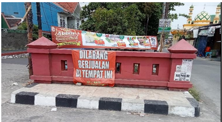
KONDISI SANDARAN DAN TROTOAR
