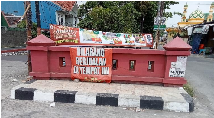
KONDISI SANDARAN DAN TROTOAR
