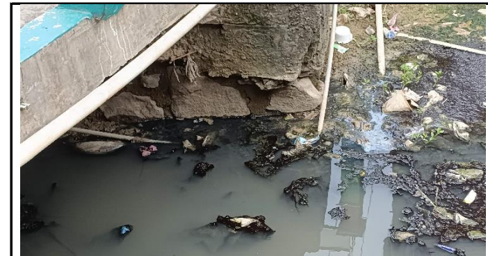
KERUSAKAN PADA BANGUNAN BAWAH
