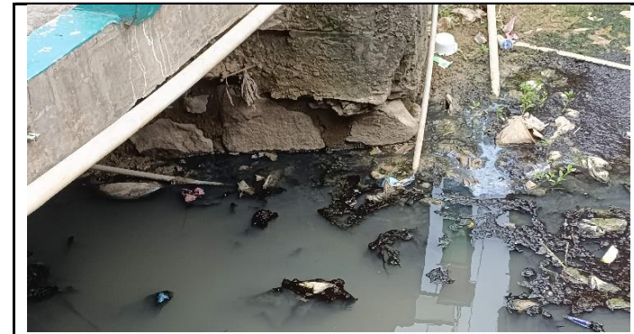
KERUSAKAN PADA BANGUNAN BAWAH
