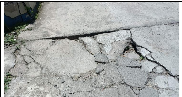
JALAN PENDEKAT BERLUBANG
