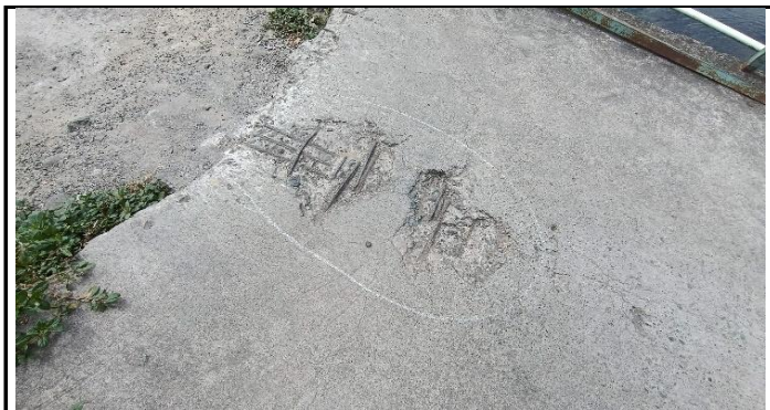
JALAN PENDEKAT BERLUBANG
