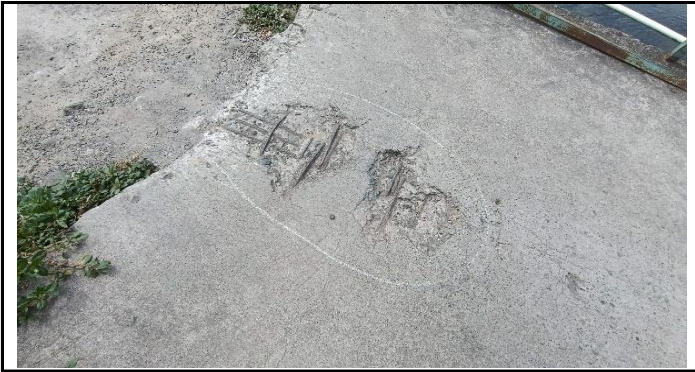
JALAN PENDEKAT BERLUBANG
