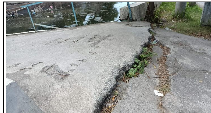
LANTAI JEMBATAN PECAH
