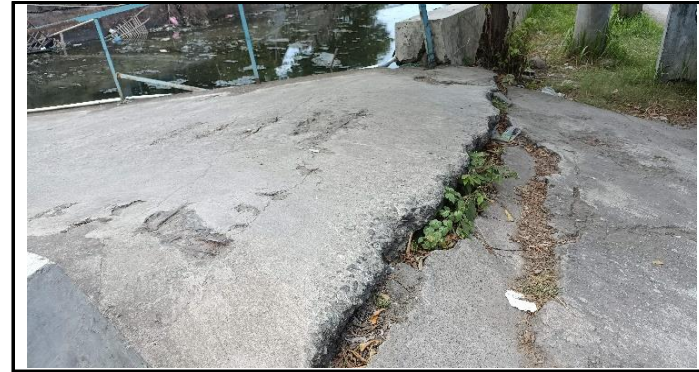
LANTAI JEMBATAN PECAH
