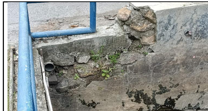
KERONTOKAN BETON PADA PENUNJANG SANDARAN
