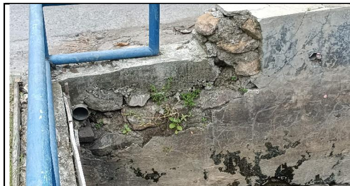
KERONTOKAN BETON PADA PENUNJANG SANDARAN
