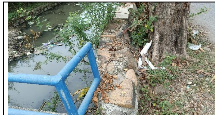
PILAR MENGALAMI PENURUNAN MUTU BETON
