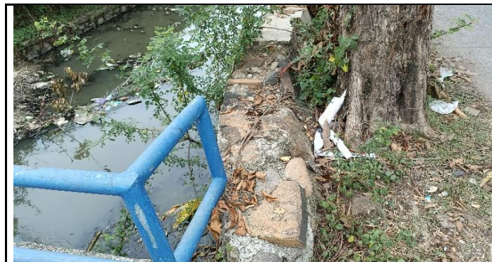
PILAR MENGALAMI PENURUNAN MUTU BETON
