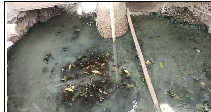
KERUSAKAN PADA TEBING SUNGAI
