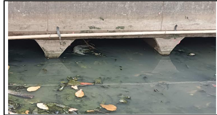
PILAR MENGALAMI PENURUNAN MUTU BETON
