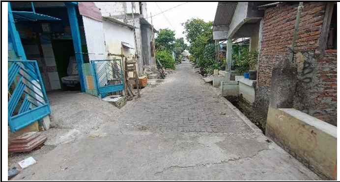
LAPISAN PERMUKAAN LANTAI BERLUBANG
