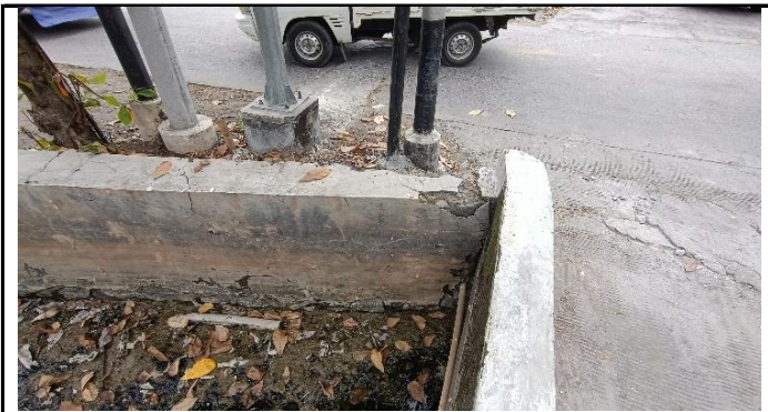
KERUSAKAN PADA TEBING SUNGAI
