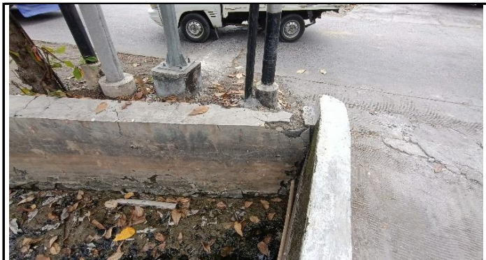
KONDISI PILAR KEROPOS
