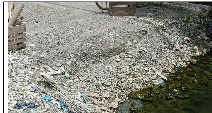
PERKERASAN JALAN PENDEKAT RUSAK
