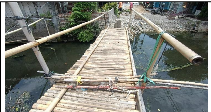
JEMBATAN DARURAT KARENA JEMBATAN ASLI RUNTUH
