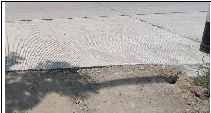
KERUSAKAN PADA JALAN PENDEKAT
