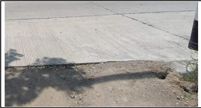
KERUSAKAN PADA JALAN PENDEKAT
