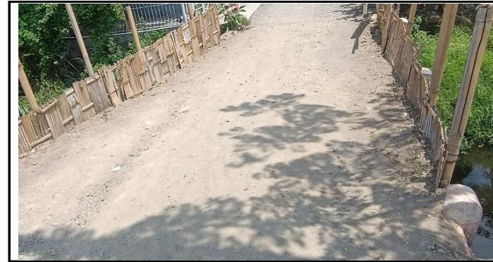
KERUSAKAN PADA LANTAI JEMBATAN
