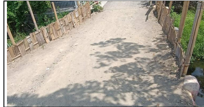
KERUSAKAN PADA LANTAI JEMBATAN
