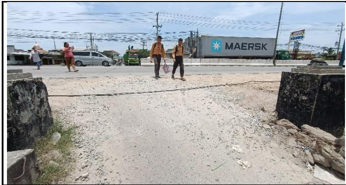
KERUSAKAN PADA JALAN PENDEKAT
