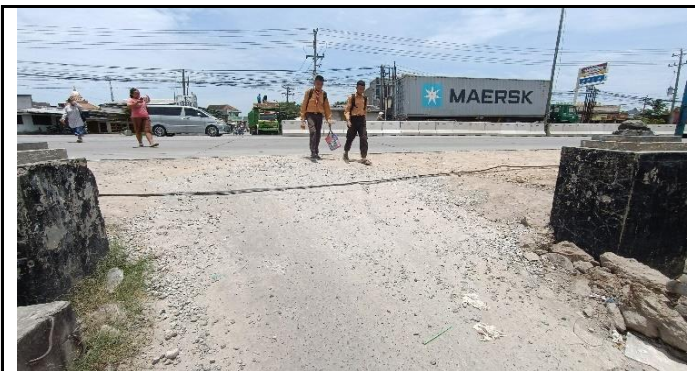
KERUSAKAN PADA JALAN PENDEKAT
