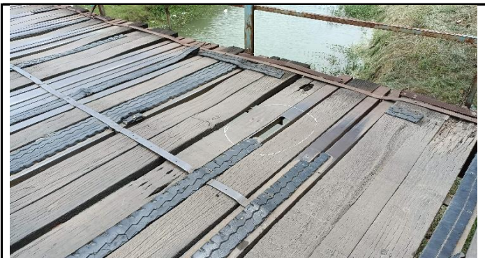
LANTAI KAYU PECAH
