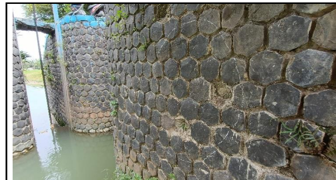
KERONTOKAN PAS. BATU PADA KEPALA JEMBATAN
