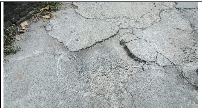
JALAN PENDEKAT BERLUBANG
