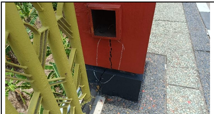
KERETAKAN PADA TIANG SANDARAN JEMBATAN
