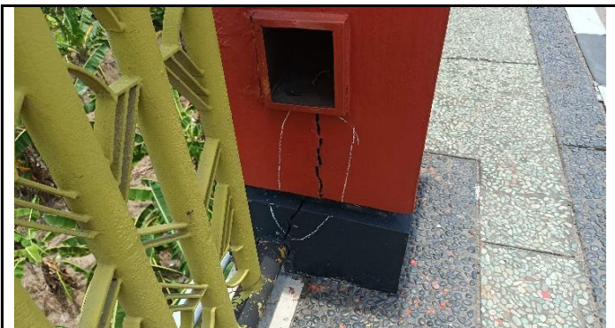
KERETAKAN PADA TIANG SANDARAN JEMBATAN
