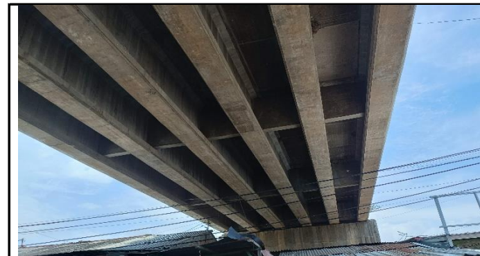
KONDISI GELAGAR PRATEKAN
