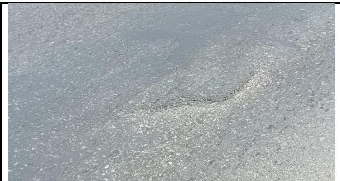
LAPISAN PERMUKAAN LANTAI BERGELOMBANG
