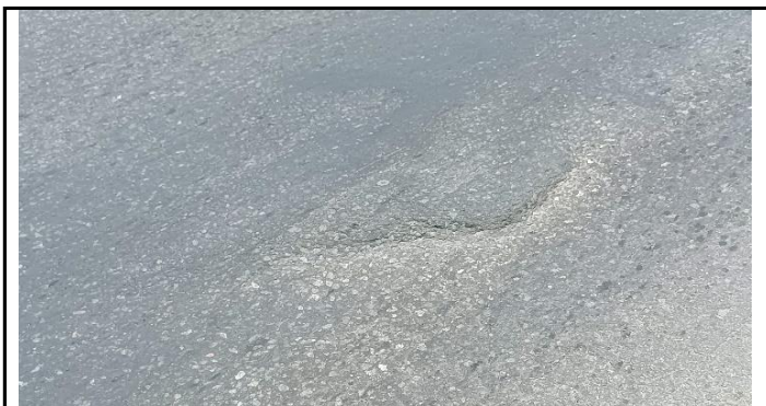
LAPISAN PERMUKAAN LANTAI BERGELOMBANG
