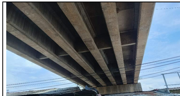
KONDISI GELAGAR PRATEKAN
