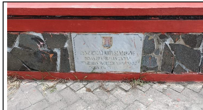
PAPAN PENANDA JEMBATAN
