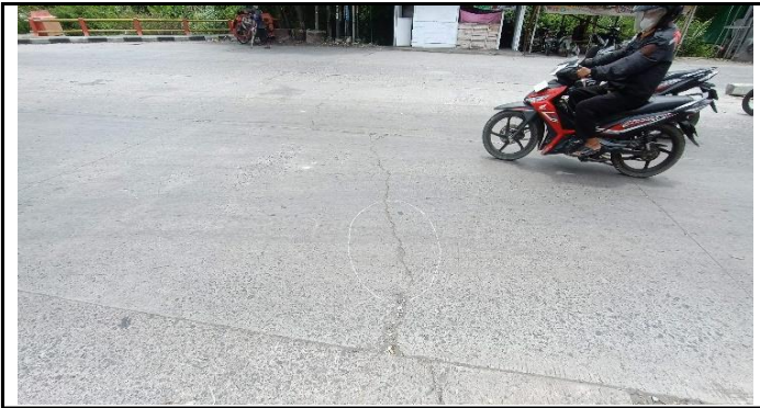
KERETAKAN PADA PERMUKAAN LANTAI
