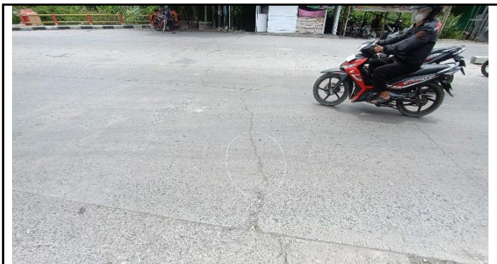
KERETAKAN PADA LANTAI JEMBATAN
