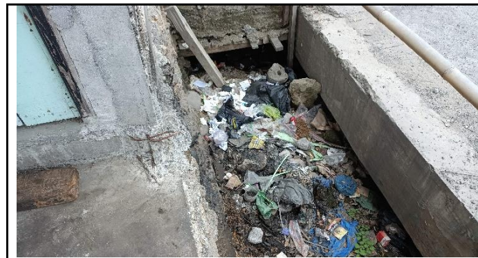
DEBRIS (TUMPUKAN SAMPAH) PADA ALIRAN SUNGAI
