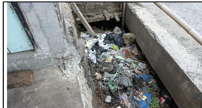
DEBRIS (TUMPUKAN SAMPAH) PADA ALIRAN SUNGAI
