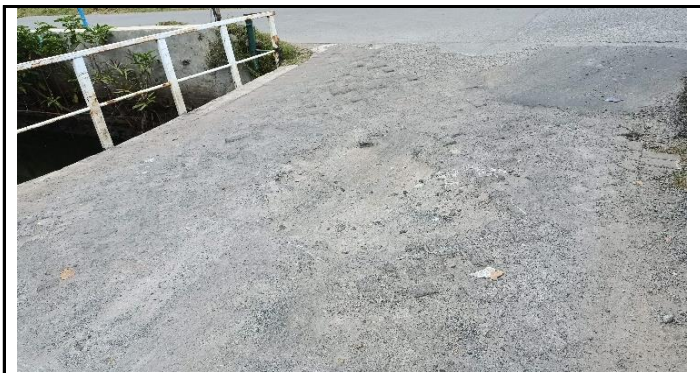
LANTAI JEMBATAN BERLUBANG
