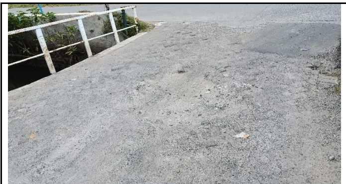
LANTAI JEMBATAN BERLUBANG
