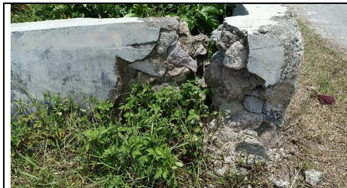
TEMBOK SEDADA PECAH
