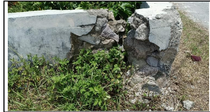
TEMBOK SEDADA PECAH
