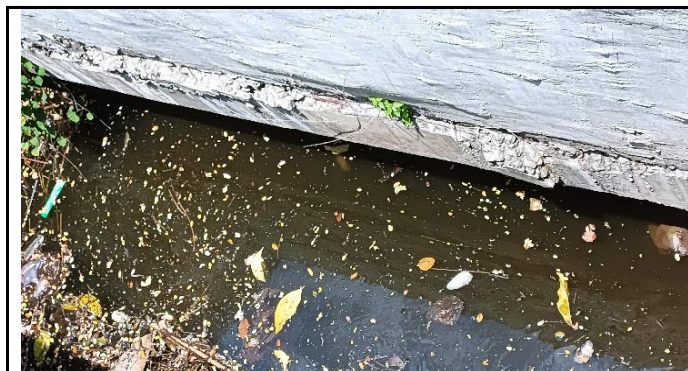
KERETAKAN PADA PELAT JEMBATAN
