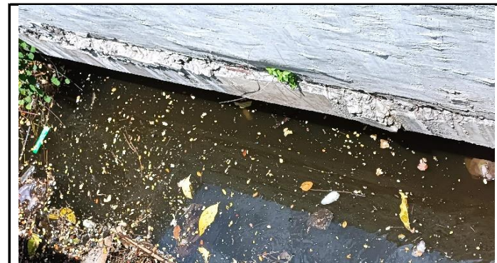
KERETAKAN PADA PELAT JEMBATAN
