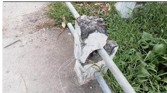
TIANG SANDARAN PECAH
