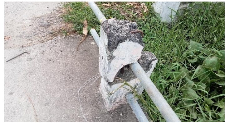
TIANG SANDARAN PECAH
