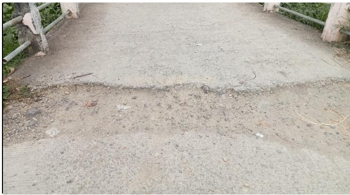
JALAN PENDEKAT BERLUBANG
