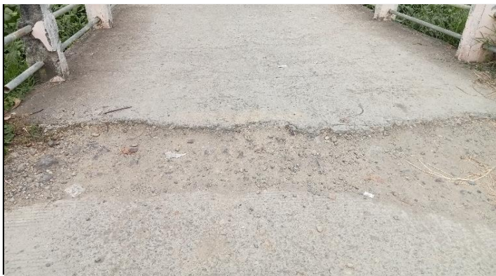
JALAN PENDEKAT BERLUBANG
