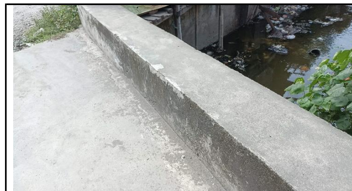
SANDARAN MEMBUTUHKAN PENGECATAN ULANG
