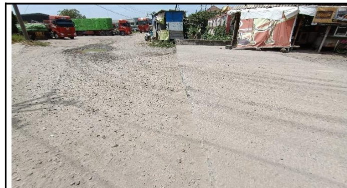
LAPISAN PERMUKAAN LANTAI JEMBATAN LICIN
