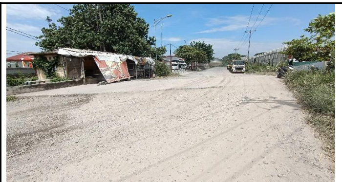
KERUSAKAN PADA JALAN PENDEKAT
