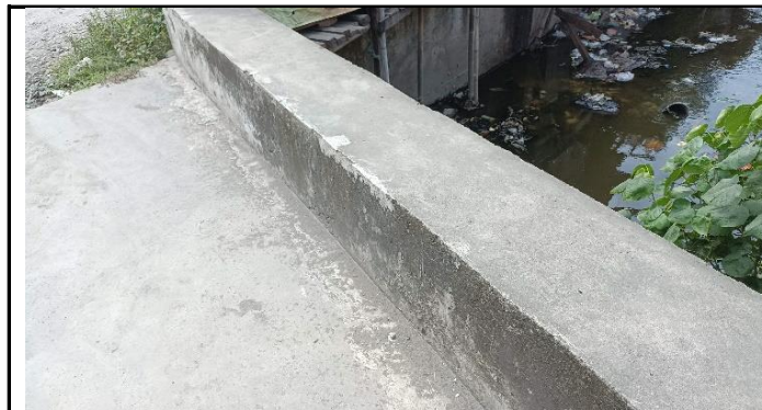
SANDARAN MEMBUTUHKAN PENGECATAN ULANG
