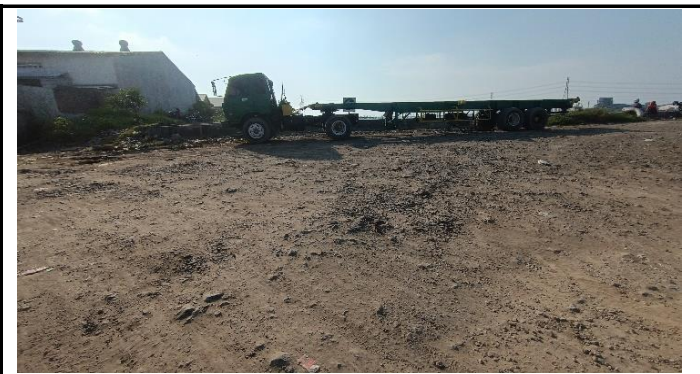
KERUSAKAN PADA JALAN PENDEKAT
