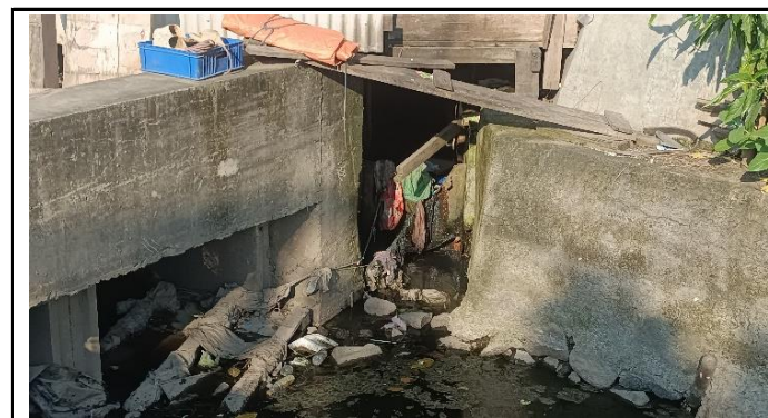
KONDISI TEBING SUNGAI
