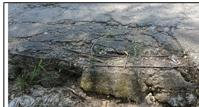
KERUSAKAN PADA JALAN PENDEKAT
