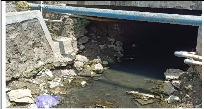
KONDISI BANGUNAN BAWAH MANGALAMI PENURUNAN MUTU BETON
