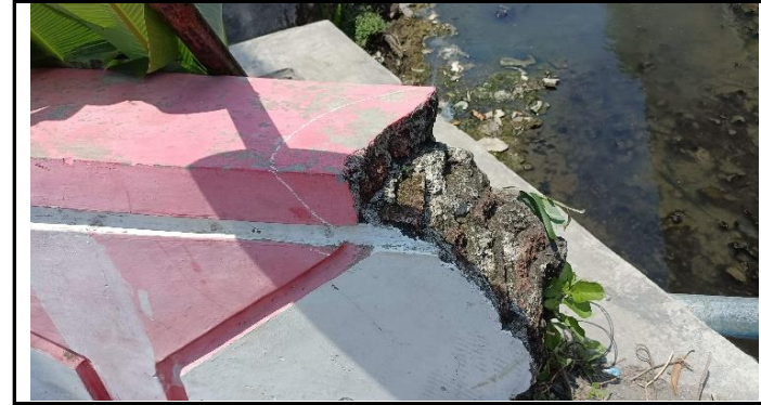
TEMBOK SEDADA PECAH
