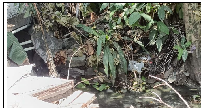
TEMBOK SAYAP LONGSOR
