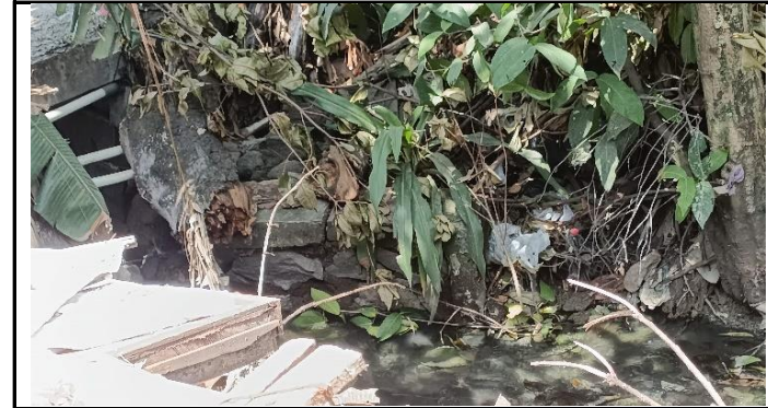
TEMBOK SAYAP LONGSOR
