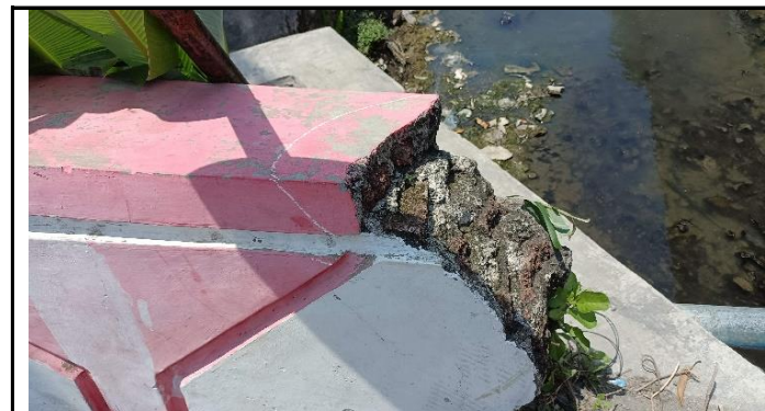
TEMBOK SEDADA PECAH
