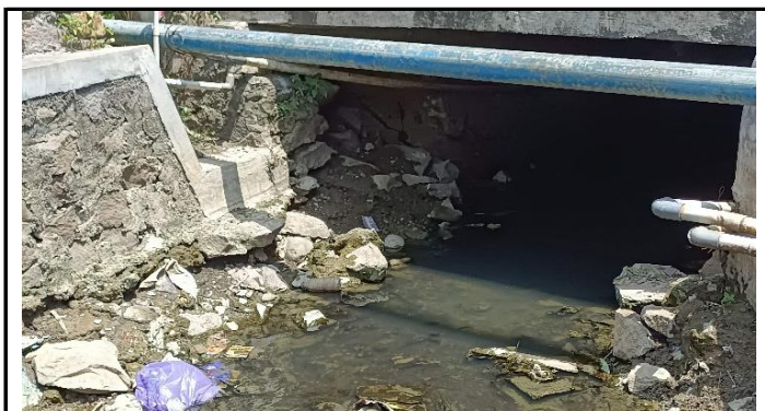
KONDISI BANGUNAN BAWAH MANGALAMI PENURUNAN MUTU BETON
