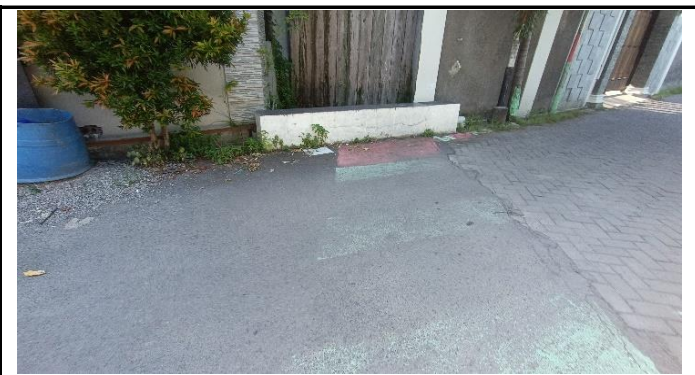
LANTAI JEMBATAN BERGELOMBANG
