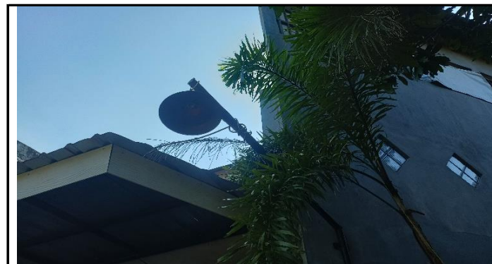
KONDISI PENERANGAN LAMPU
