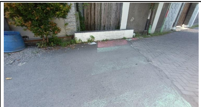
KONDISI LAPISAN PERMUKAAN LANTAI
