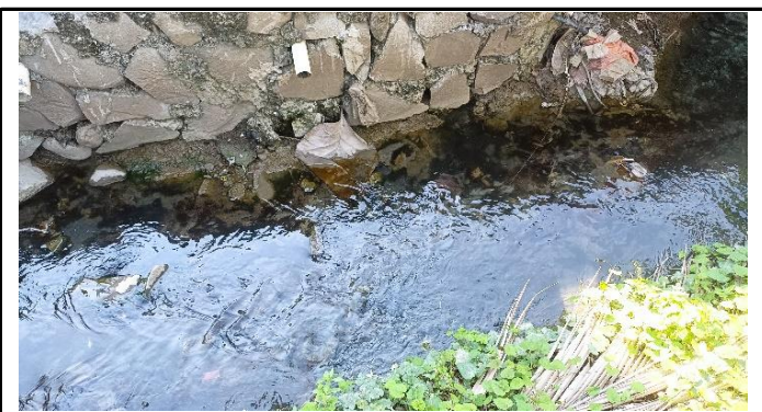
KONDISI BANGUNAN BAWAH MENGALAMI PENUAAN BETON
