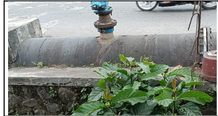
UTILITAS TIDAK SESUAI DENGAN PENEMPATANNYA
