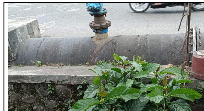
UTILITAS TIDAK SESUAI DENGAN PENEMPATANNYA
