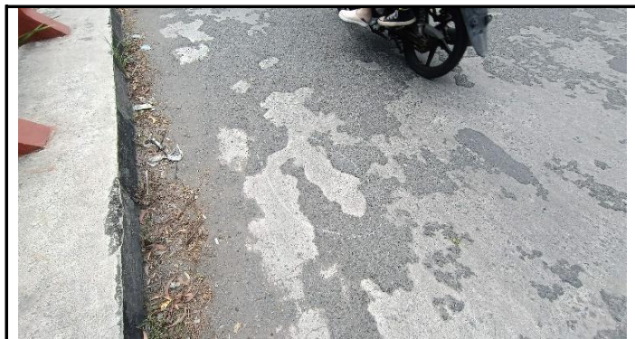
JALAN BERGELOMBANG PADA LANTAI JEMBATAN
