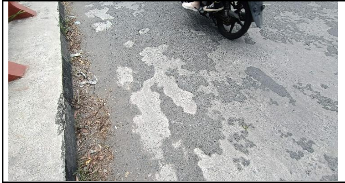
JALAN BERGELOMBANG PADA LANTAI JEMBATAN
