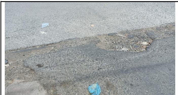
JALAN BERLUBANG PADA JALAN PENDEKAT
