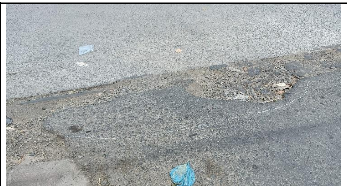
JALAN BERLUBANG PADA JALAN PENDEKAT
