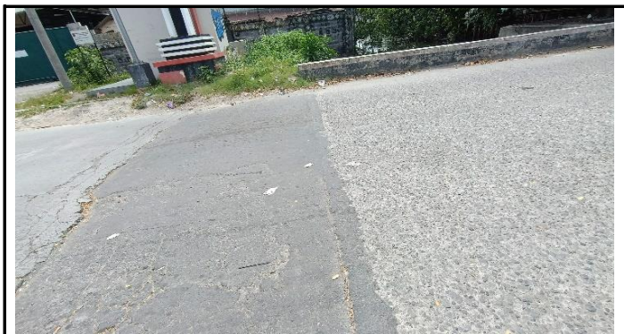
LANTAI JEMBATAN BERGELOMBANG
