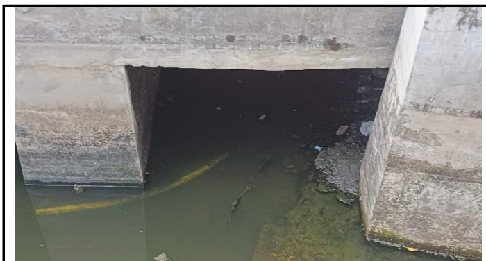
KONDISI BANGUNAN BAWAH MENGALAMI PENUAAN BETON
