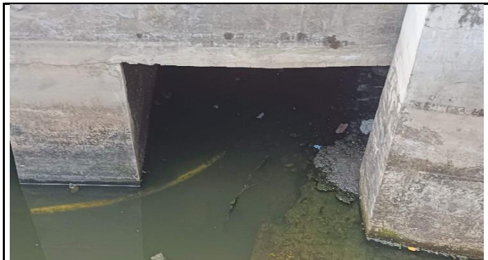
KONDISI BANGUNAN BAWAH MENGALAMI PENUAAN BETON
