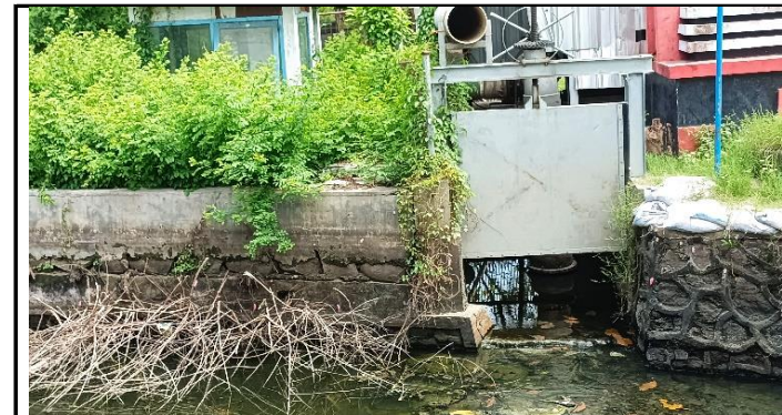
SEDIMENTASI DAN DEBRIS ALIRAN SUNGAI
