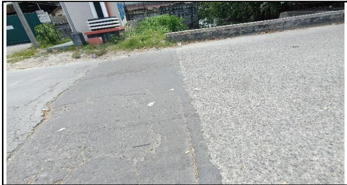
LANTAI JEMBATAN BERGELOMBANG
