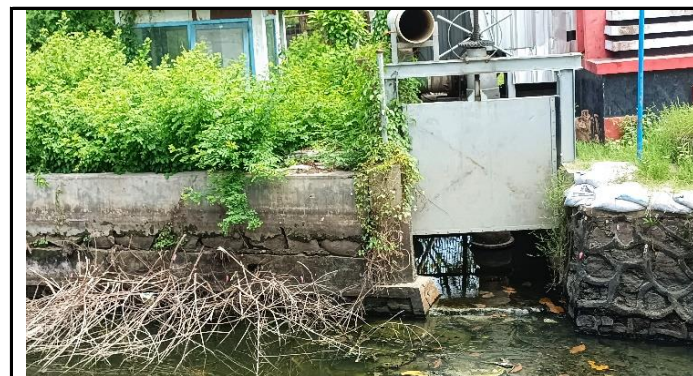
SEDIMENTASI DAN DEBRIS ALIRAN SUNGAI
