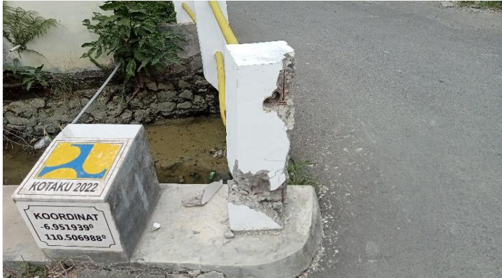
TIANG SANDARAN PECAH
