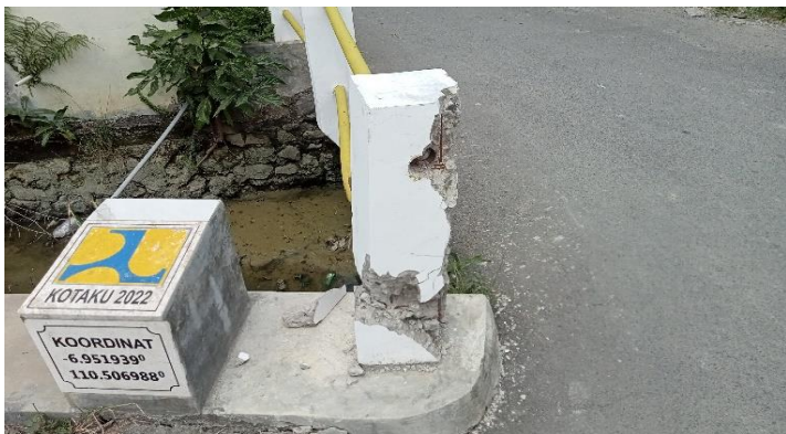
TIANG SANDARAN PECAH
