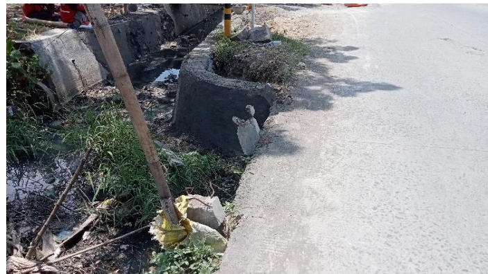
KONDISI SANDARAN HANCUR
