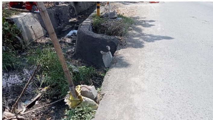
KONDISI SANDARAN HANCUR
