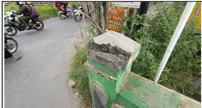
TEMBOK SEDADA PECAH
