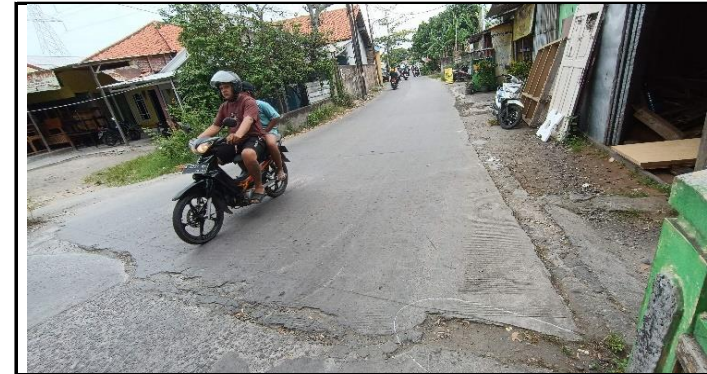
JALAN PENDEKAT BERLUBANG
