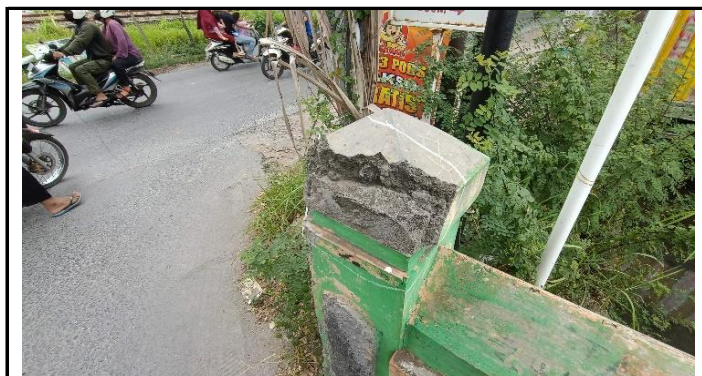
TEMBOK SEDADA PECAH
