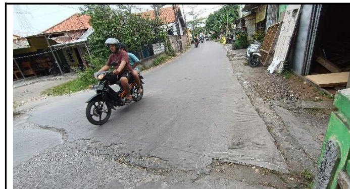
JALAN PENDEKAT BERLUBANG
