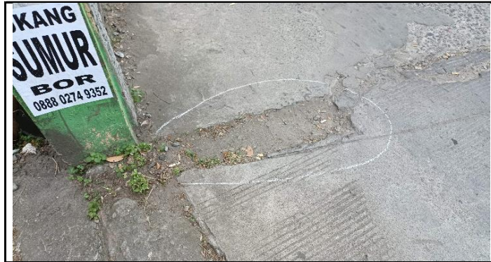
LANTAI JEMBATAN BERLUBANG
