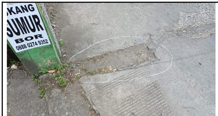
LANTAI JEMBATAN BERLUBANG
