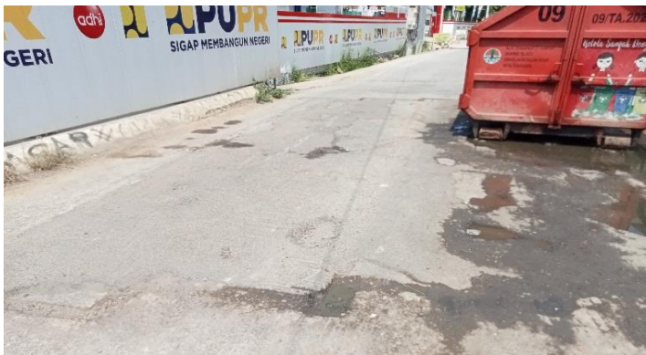
KONDISI LATAI BERLUBANG
