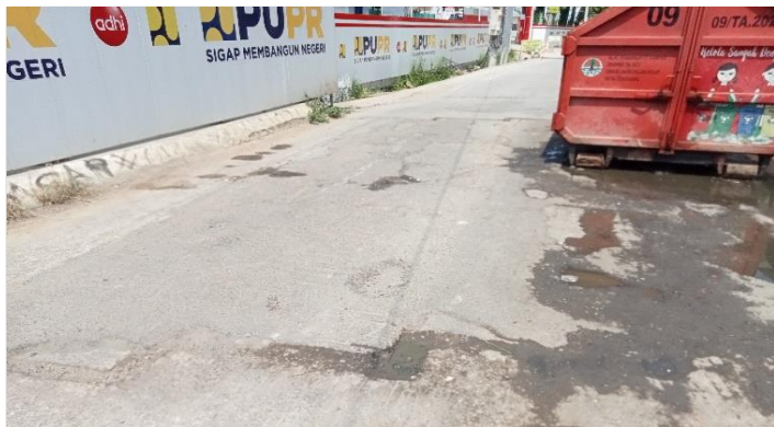
KONDISI LATAI BERLUBANG
