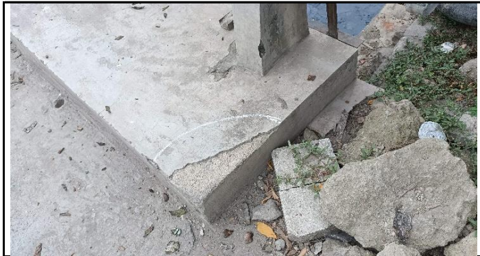
KERONTOKAN BETON PADA TROTOAR
