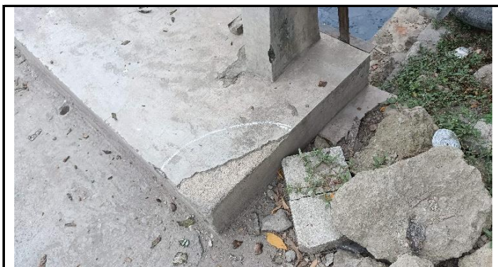
KERONTOKAN BETON PADA TROTOAR
