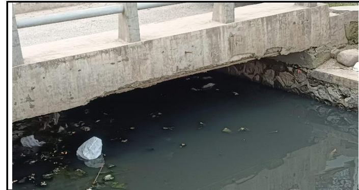
KERONTOKAN BETON PADA PELAT JEMBATAN
