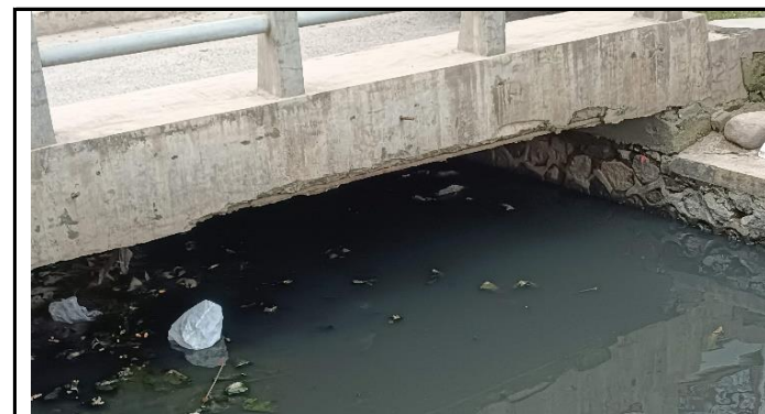
KERONTOKAN BETON PADA PELAT JEMBATAN
