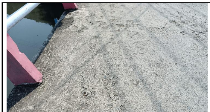
LAPISAN PERMUKAAN LANTAI BERGELOMBANG
