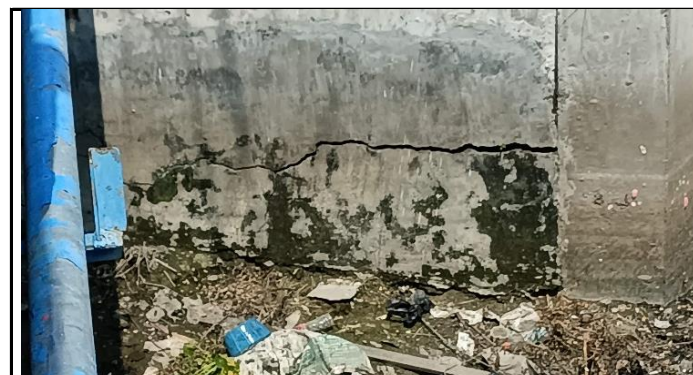
KERETAKAN PADA BANGUNAN PENGAMAN TEBING SUNGAI
