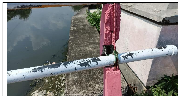
TIANG SANDARAN PECAH
