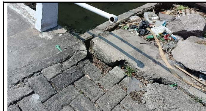
DINDING PENAHAN TANAH JALAN PENDEKAT RETAK
