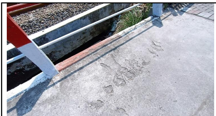
LANTAI JEMBATAN BERLUBANG
