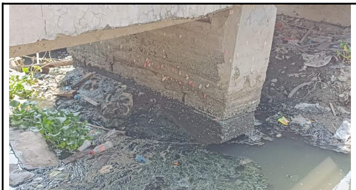
PONDASI PILAR JEMBATAN TERGERUS
