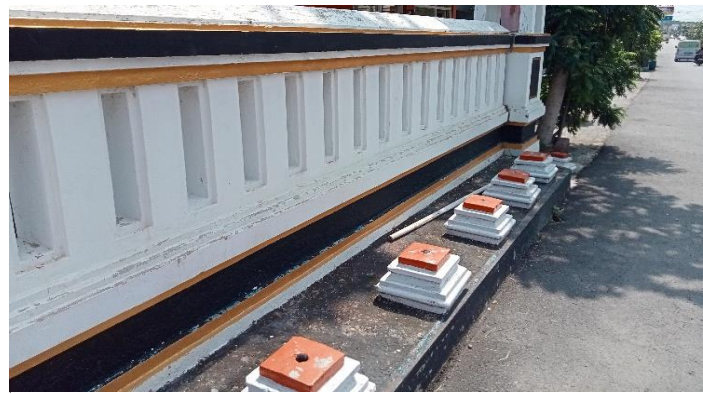
KONDISI SANDARAN DAN TROTOAR
