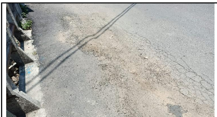
LAPISAN PERMUKAAN LANTAI BERGELOMBANG
