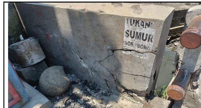
TEMBOK SEDADA RETAK
