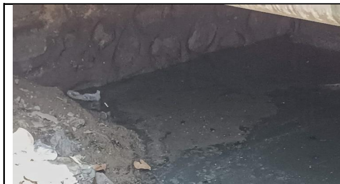
KEPALA JEMBATAN MENGALAMI PENURUNAN MUTU
