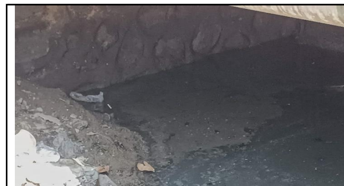
KEPALA JEMBATAN MENGALAMI PENURUNAN MUTU
