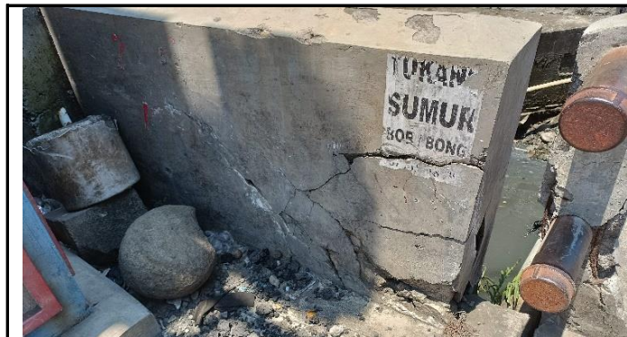
TEMBOK SEDADA RETAK
