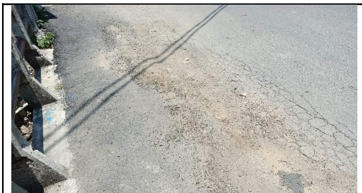
LAPISAN PERMUKAAN LANTAI BERGELOMBANG
