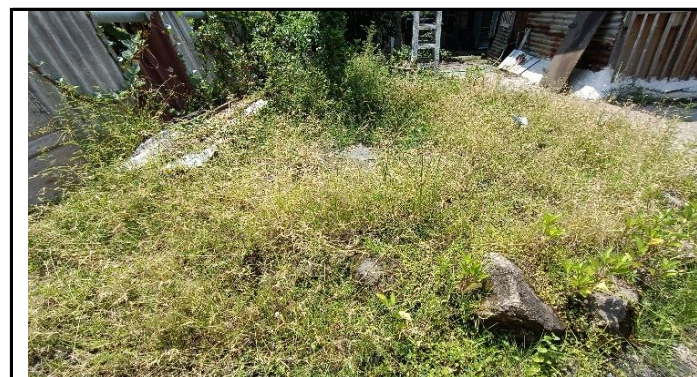
TANAH TIMBUNAN DIATAS JEMBATAN
