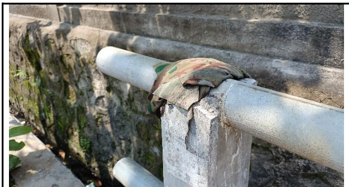
KERONTOKAN BETON PADA SANDARAN
