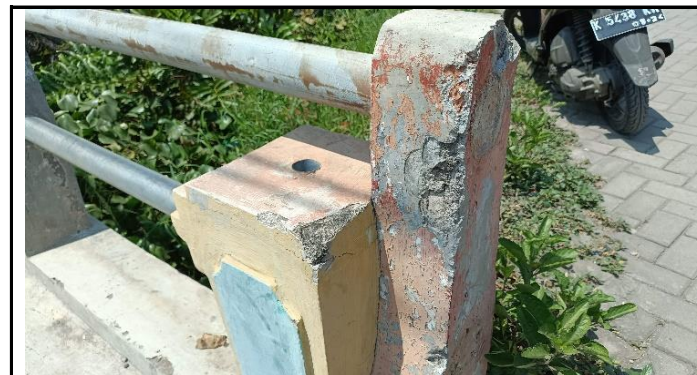
KERETAKAN PADA SANDARAN
