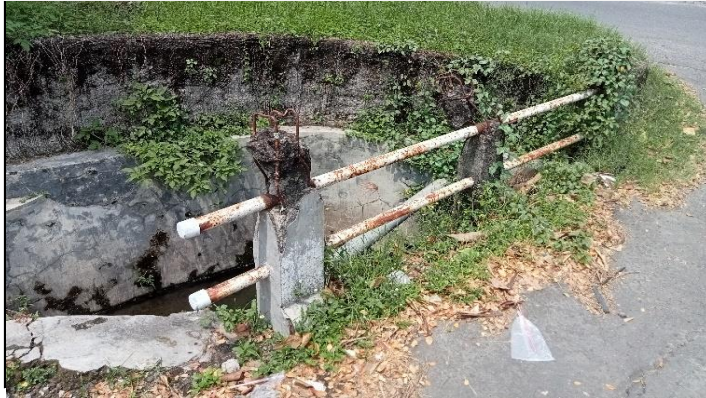
TIANG SANDARAN PECAH
