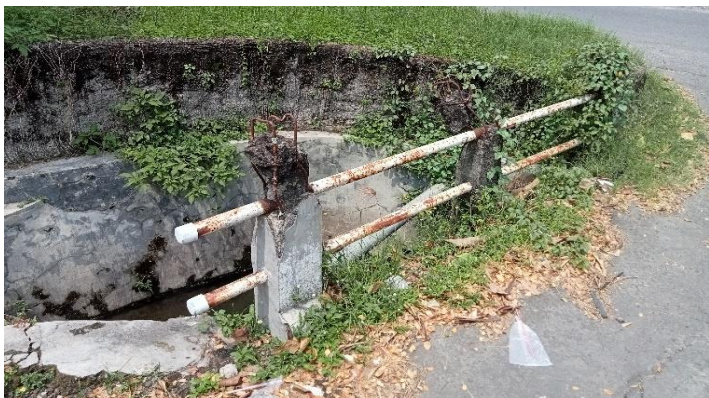
TIANG SANDARAN PECAH
