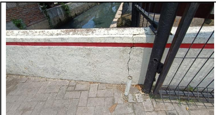
KERETAKAN PADA TEMBOK SEDADA
