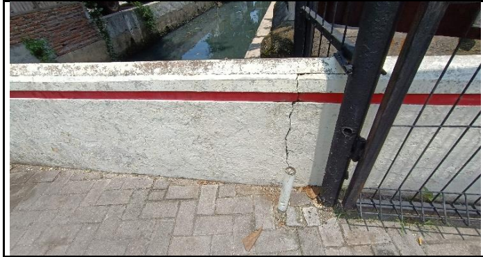
KERETAKAN PADA TEMBOK SEDADA
