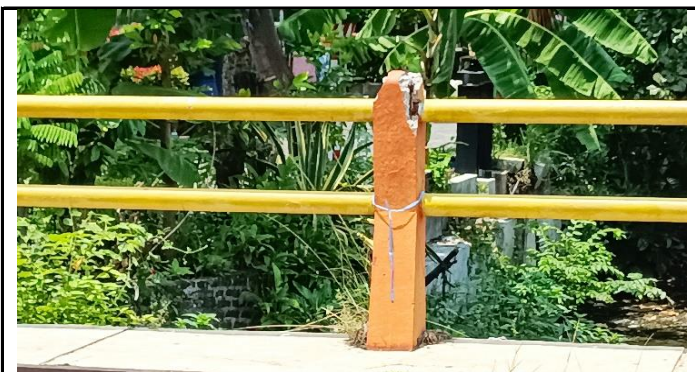
TIANG SANDARAN RETAK
