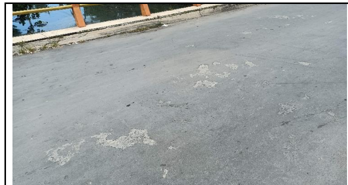
LAPISAN PERMUKAAN LANTAI BERGELOMBANG
