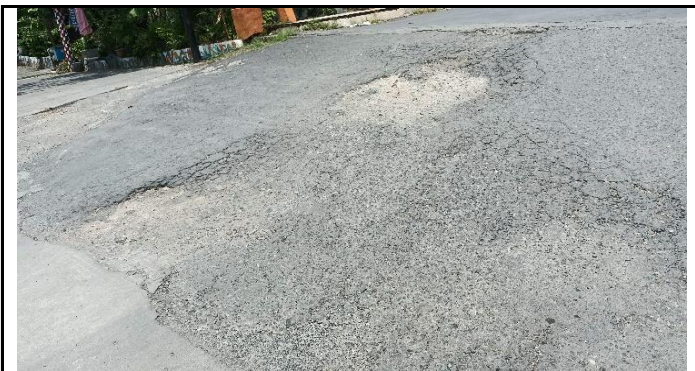
KONDISI JALAN PENDEKAT BERGELOMBANG
