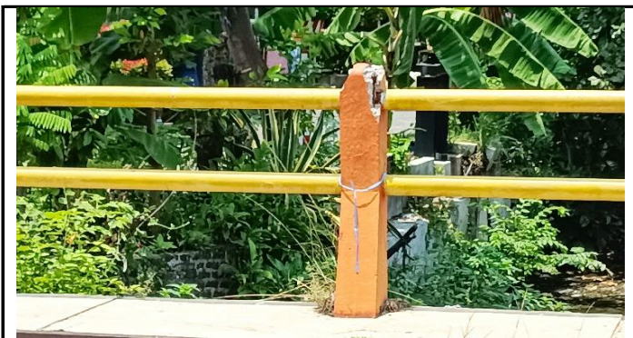
TIANG SANDARAN RETAK
