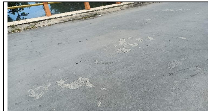
LAPISAN PERMUKAAN LANTAI BERGELOMBANG
