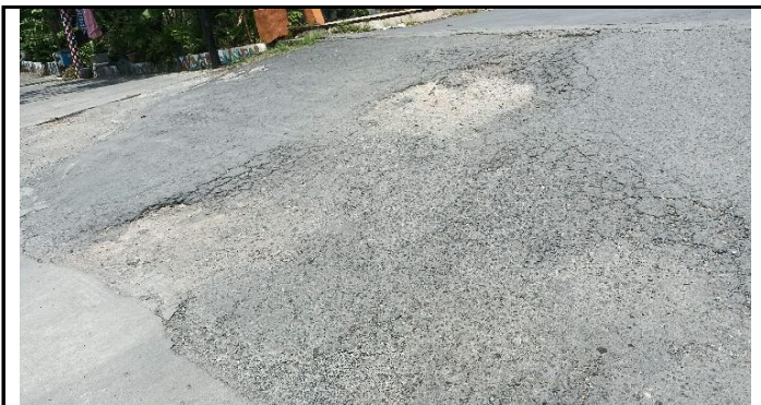
KONDISI JALAN PENDEKAT BERGELOMBANG
