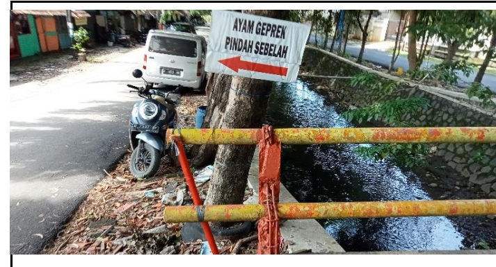
TIANG SANDARAN PECAH
