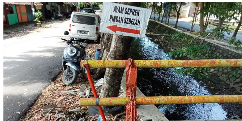
TIANG SANDARAN PECAH
