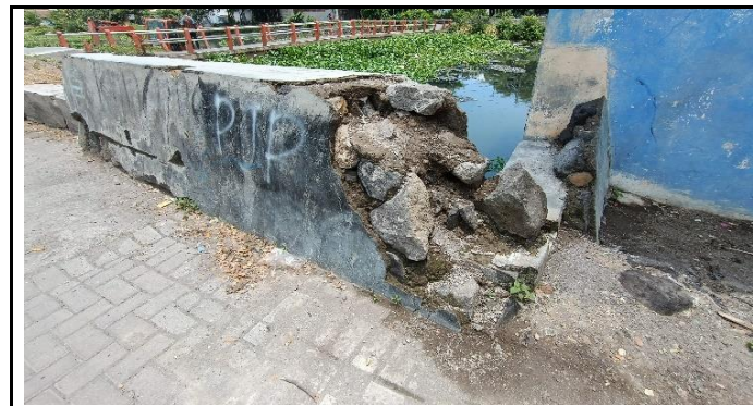
TEMBOK SEDADA PECAH
