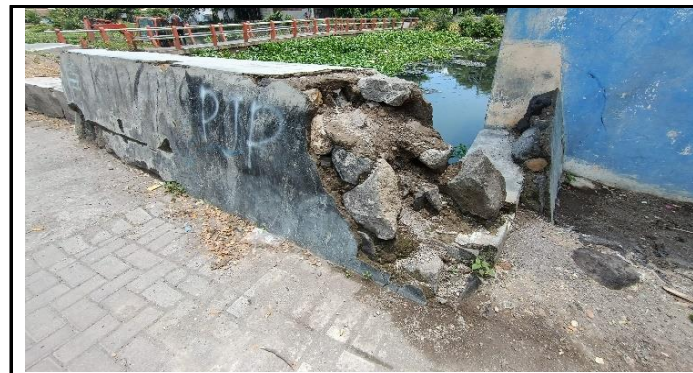
TEMBOK SEDADA PECAH
