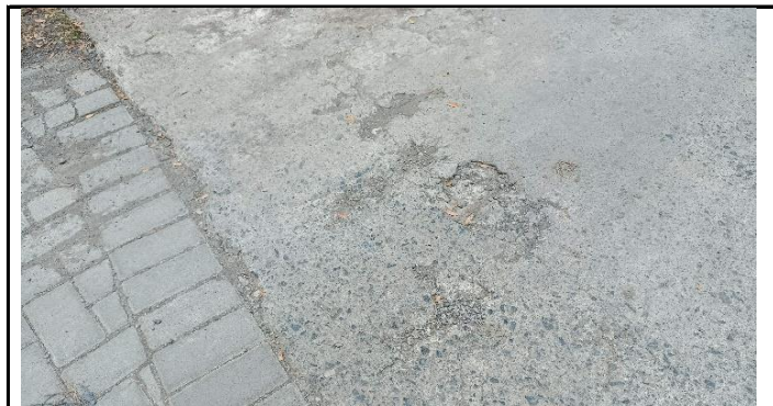
LAPISAN PERMUKAAN LANTAI JEMBATAN BERLUBANG
