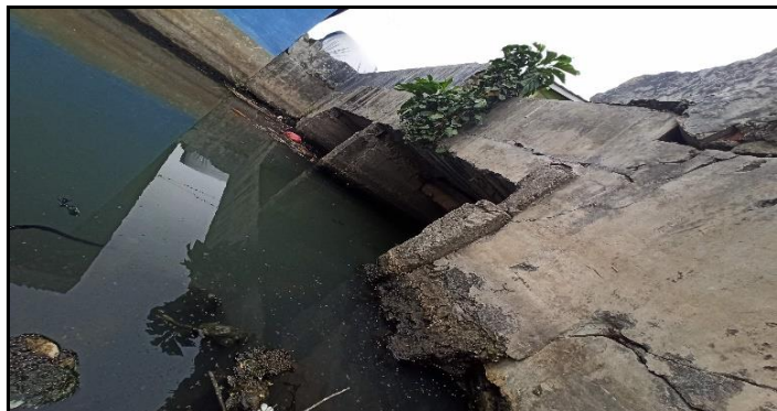
KERETAKAN PADA KEPALA JEMBATAN
