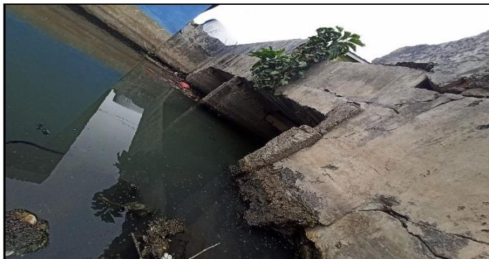
KERETAKAN PADA KEPALA JEMBATAN
