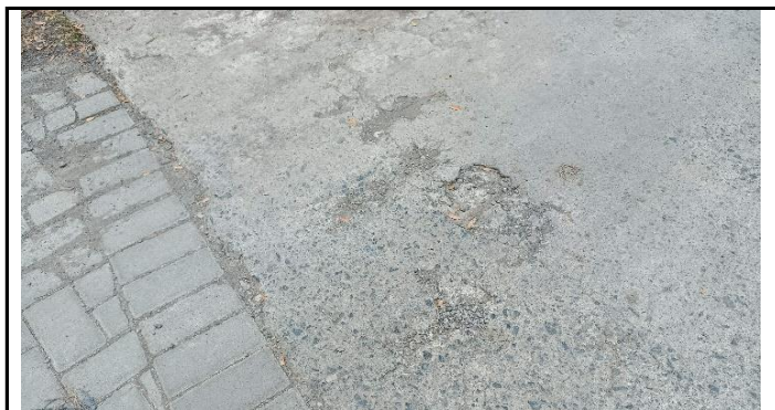
LAPISAN PERMUKAAN LANTAI JEMBATAN BERLUBANG
