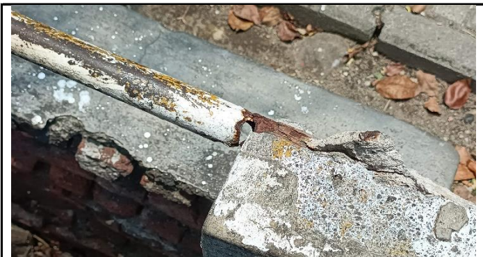
KERUSAKAN PADA SANDARAN
