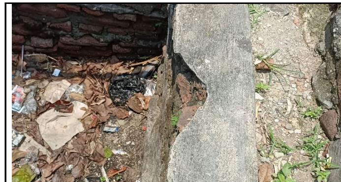
KERUSAKAN PADA SANDARAN
