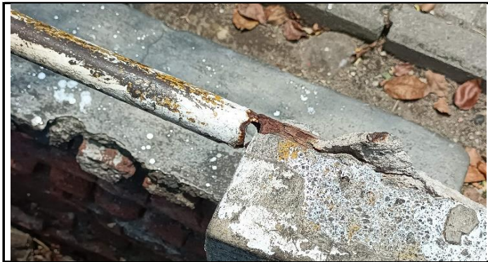
KERUSAKAN PADA SANDARAN
