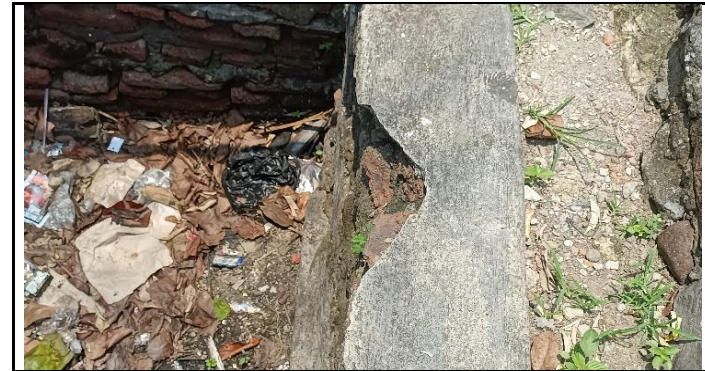
KERUSAKAN PADA SANDARAN
