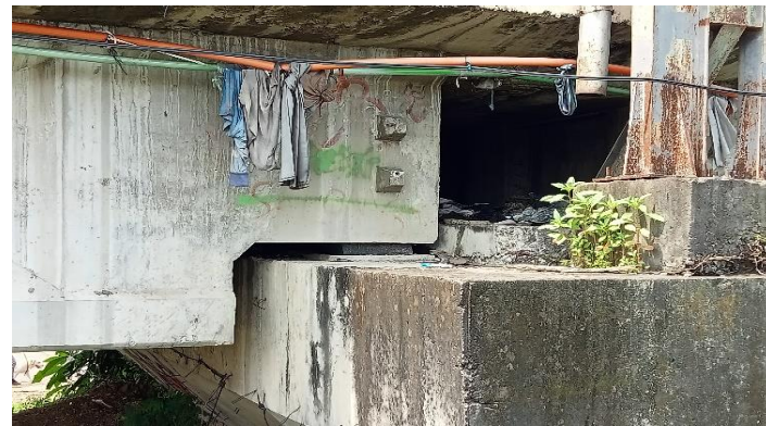
KONDISI PERLETAKAN ELASTOMER
