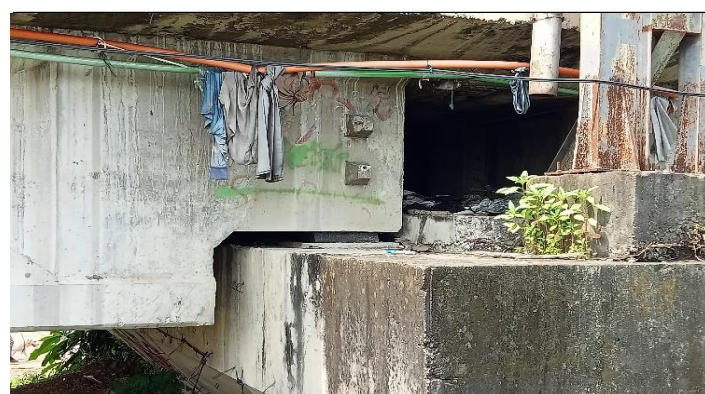
KONDISI PERLETAKAN ELASTOMER
