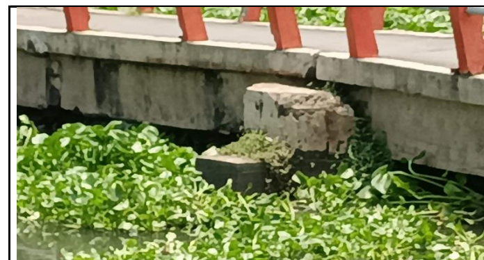
PENURUNAN MUTU BETON PADA PILAR JEMBATAN
