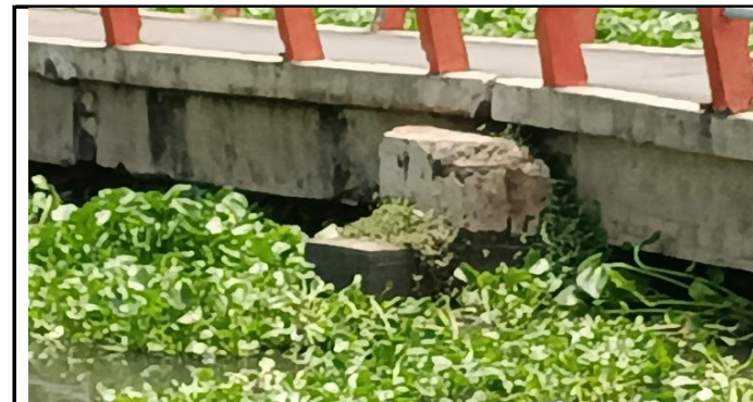
PENURUNAN MUTU BETON PADA PILAR JEMBATAN
