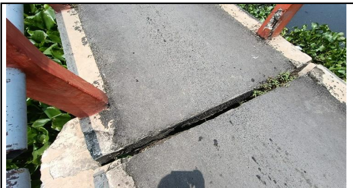
SAMBUNGAN PADA LANTAI JEMBATAN LONGGAR
