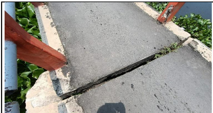
SAMBUNGAN PADA LANTAI JEMBATAN LONGGAR
