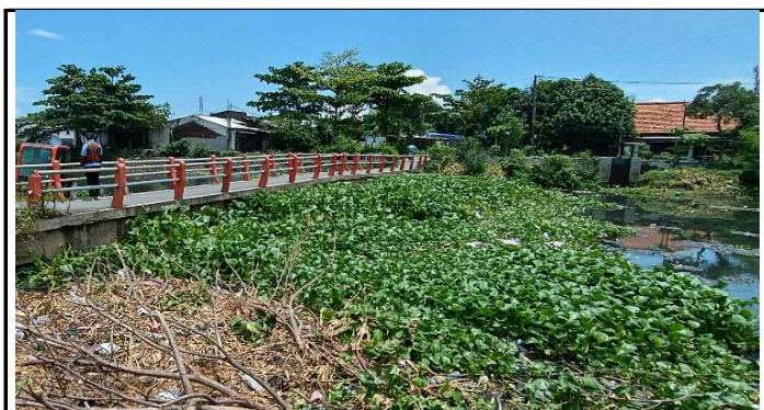
PENUMPUKAN DEBRIS PADA ALIRAN SUNGAI
