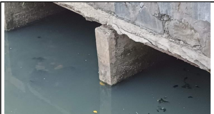
MUTU BETON RENDAH PADA BANGUNAN BAWAH
