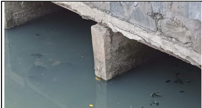
MUTU BETON RENDAH PADA BANGUNAN BAWAH
