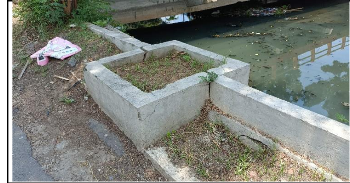
SANDARAN TERLALU RENDAH DAN RETAK BETON
