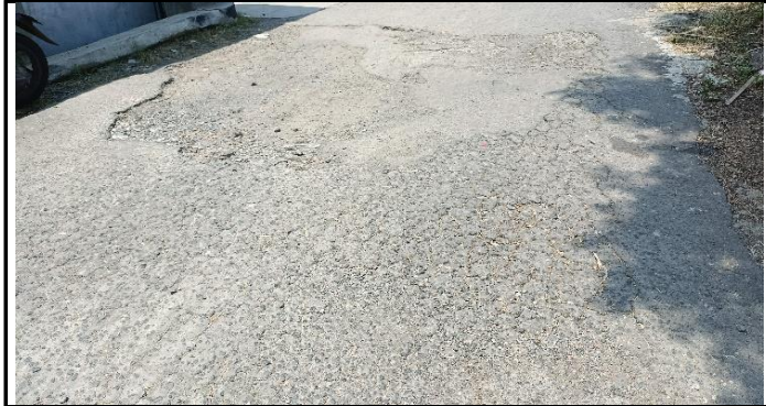
LANTAI JEMBATAN BERLUBANG
