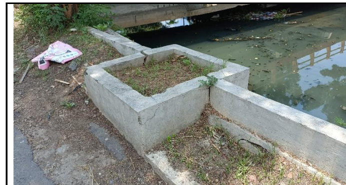
SANDARAN TERLALU RENDAH DAN RETAK BETON
