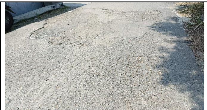
LANTAI JEMBATAN BERLUBANG
